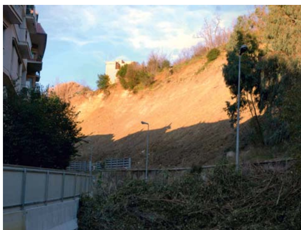
Fig. 18 – Via Labriola, fase post-disgaggio dell'evento franoso del dicembre 2008 (F137 in figura 15 b).
