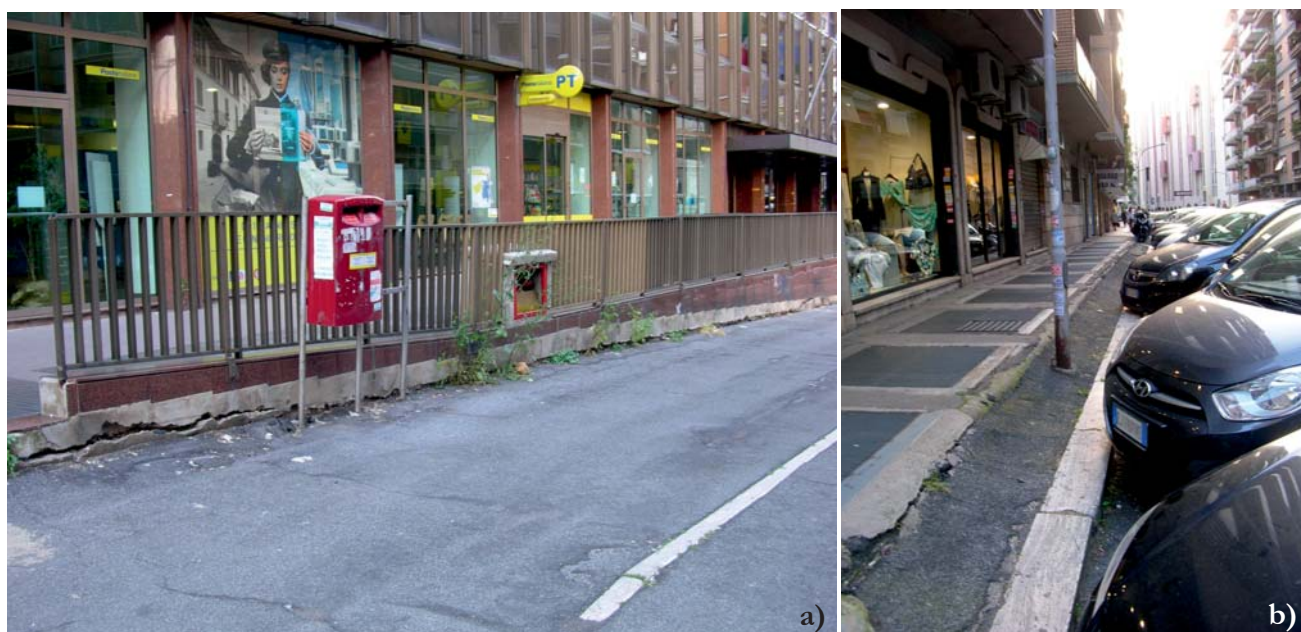
Fig. 31 – a) cedimenti del piano stradale in Via Antoniotto Usodimare (2012); b) cedimenti del piano stradale in Via Guglielmo Ciamarra (2012).
